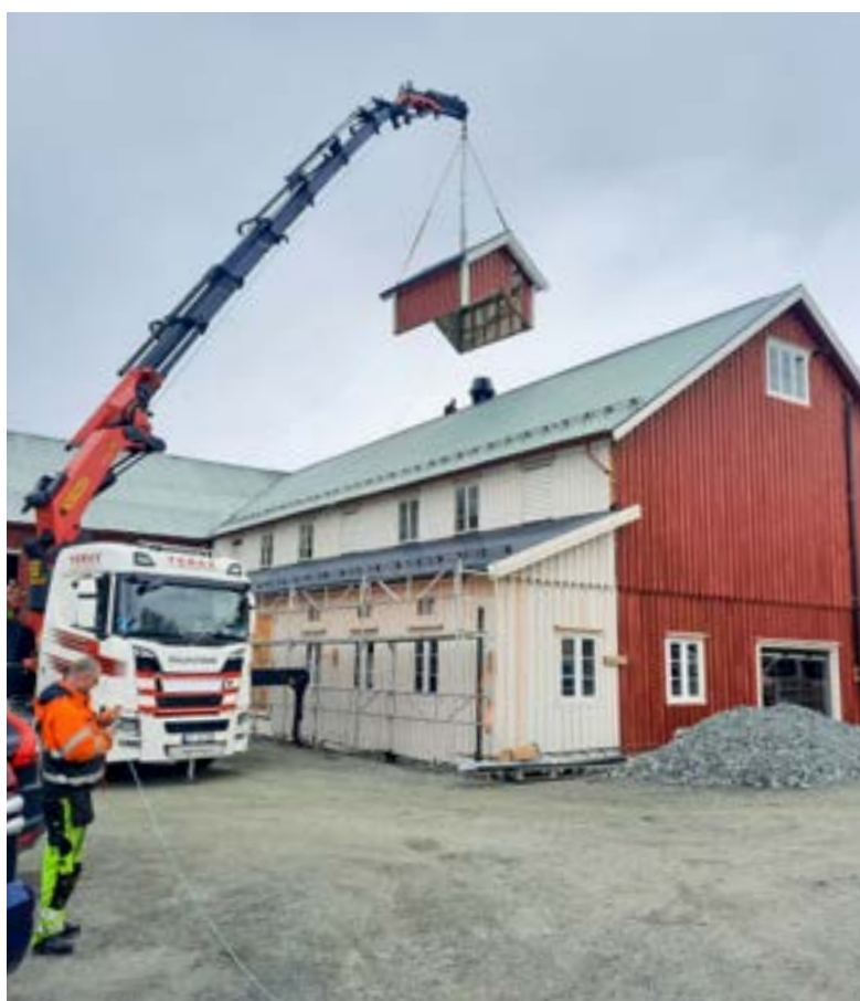
Krona på verket? Kasse for å skjule luftinntaket til fjøset, for å få bygningen til å passe inn på det gamle, freda tunet. Stort vindu med innsyn til roboten på kortveggen. Foto: Anton Jensen
